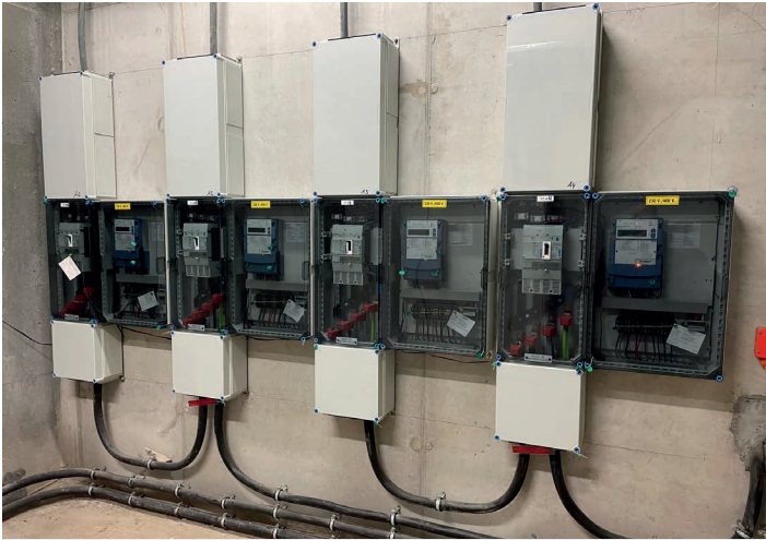
Slimme meters zijn voor energiedelen noodzakelijk. Via extra dongles op de P1-poort kan ook de gebruiker optioneel real-time data uitlezen.
