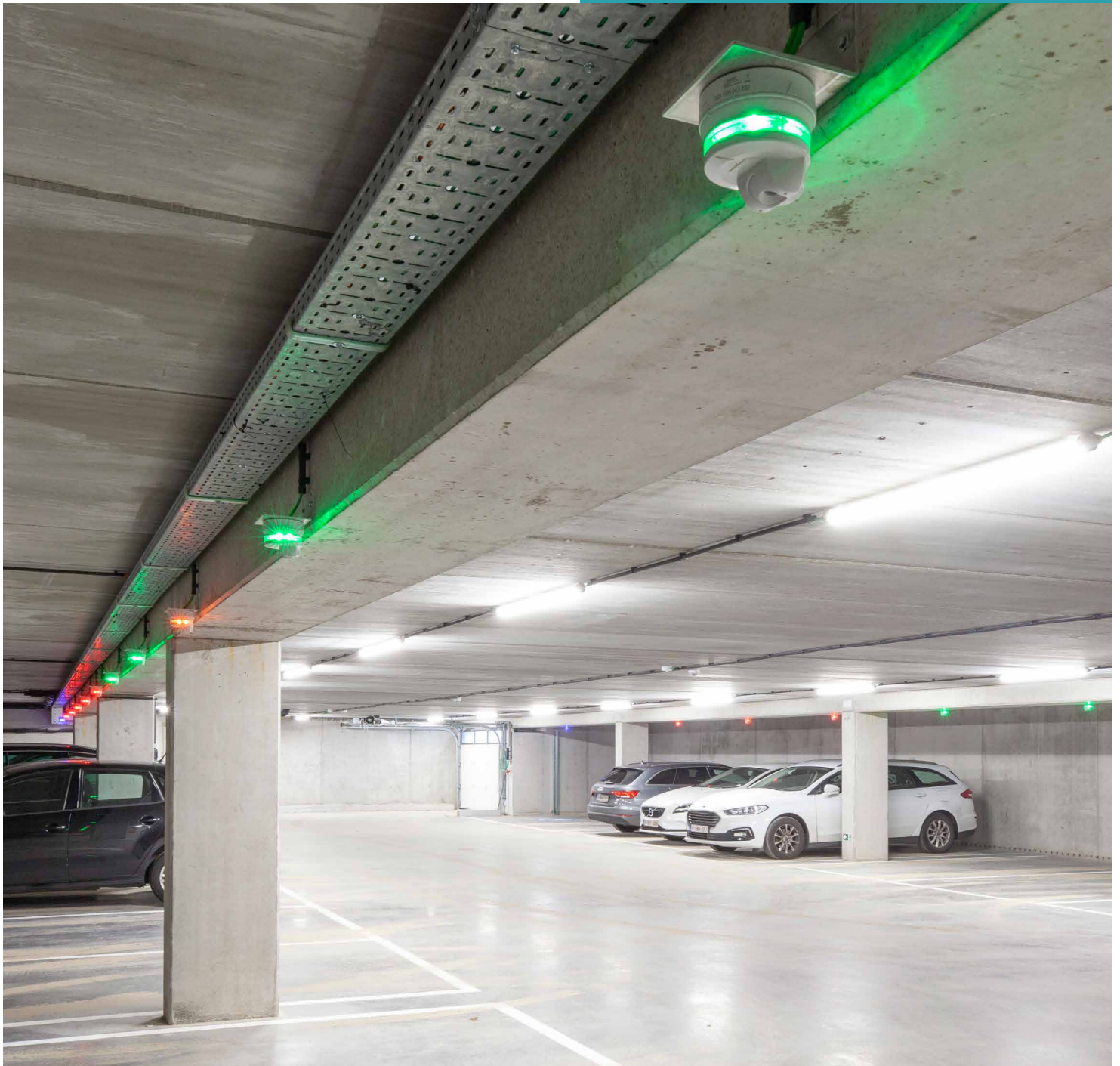
VMANAGER bevat ondermeer een parkeerbeheeroplossing op basis van nummerplaatherkenning die aan het reservatiesysteem van de parking is gekoppeld. Daarnaast gebeurt er ook een telling van de voertuigen in de parking. ©Philippe Van Gelooven
