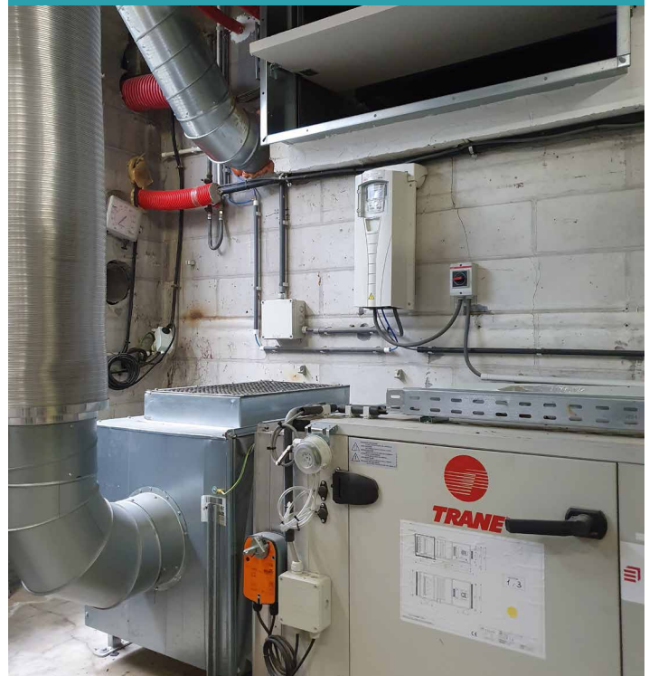
Steeds vaker zijn er meters in de luchtgroepen geïntegreerd. Deze worden echter nog al te weinig met het gebouwbeheersysteem gekoppeld.
