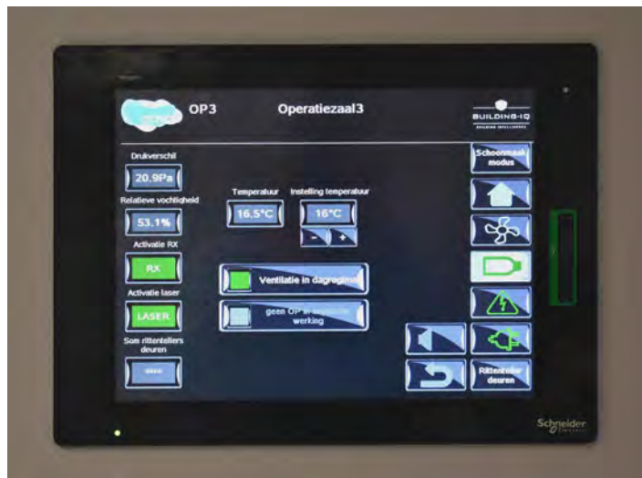
In de operatiekamers kunnen chirurgen onder meer de klimaatregeling raadplegen en instellen. Deze applicatie werd volledig in-house door Building-IQ ontwikkeld.
